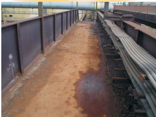
Povrch před otryskáním
