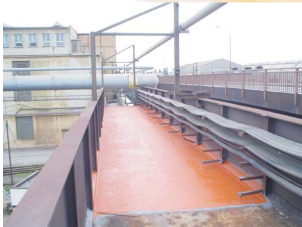
Penetrace podkladu po částech
